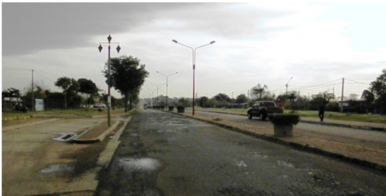
Estado de los pavimentos antes de la intervención
