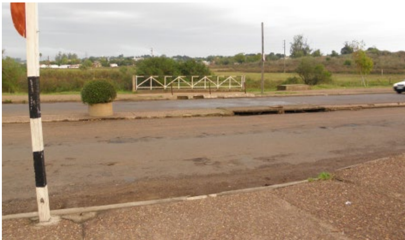
Estado de cordones y bocas de tormenta antes de la intervención
